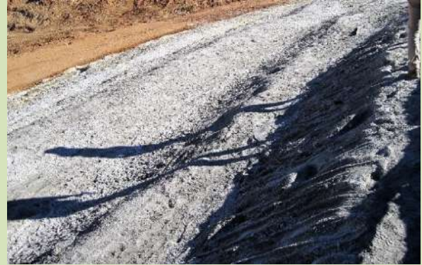
La digue évolue selon le même procédé avec des gradins qui nécessitent encore un compactage adéquat
