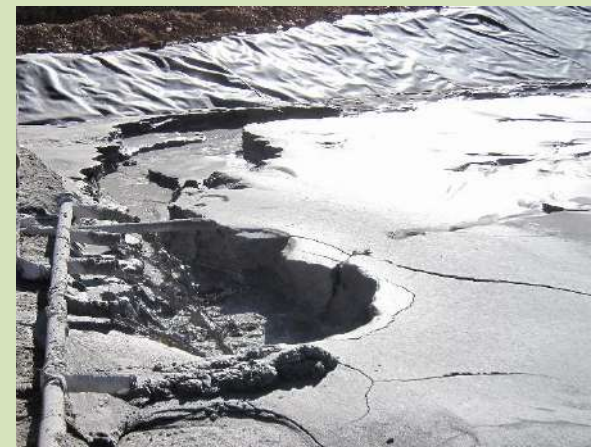
Affouillements en relation avec les déversements des boues et qu'il ne faut pas tolérer à proximité du mur
