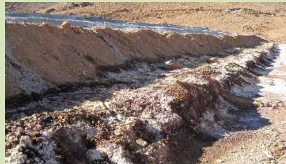
Des suintements en aval de la digue liés à l'étanchéité et qu'il faut remédier
