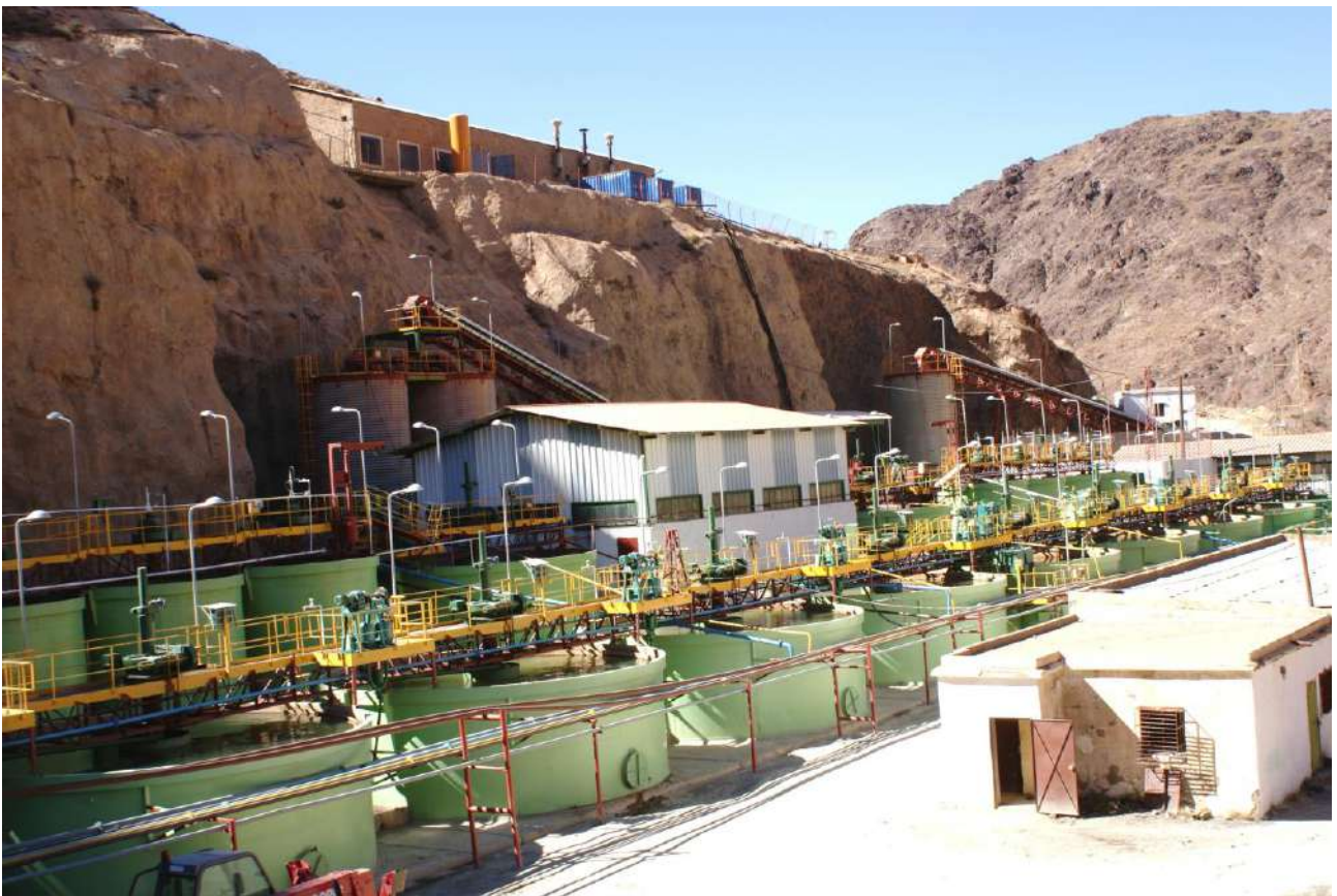
Figure 4 : Usine de cyanuration
